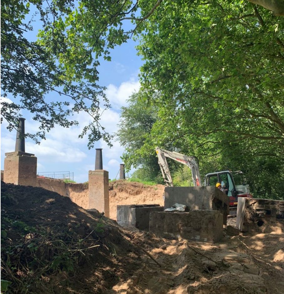
Als test is al een deel van de voor de waterlinie essentiële inlaatsluis vrij gelegd
